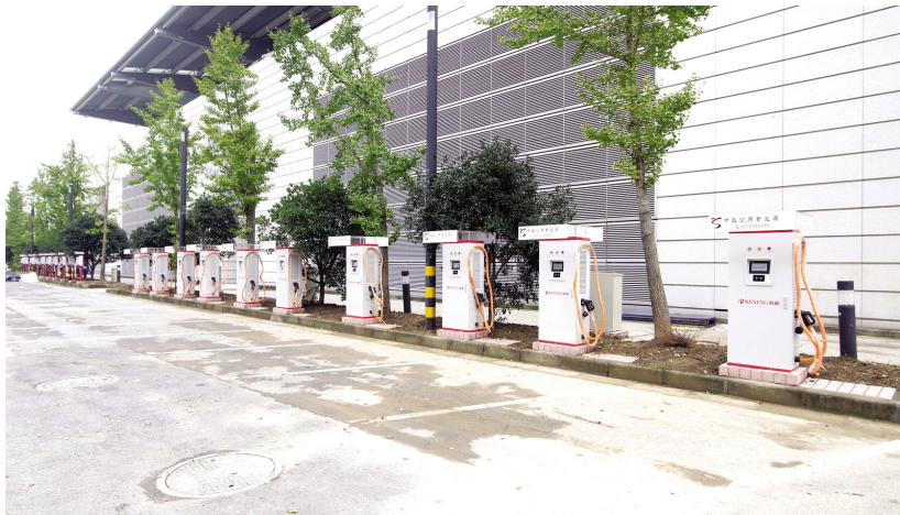
新能源充电桩
